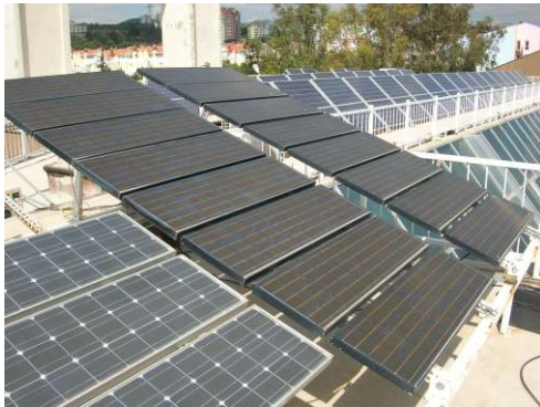
Şekil-2 Fotovoltaik modüllerin görünüşü
